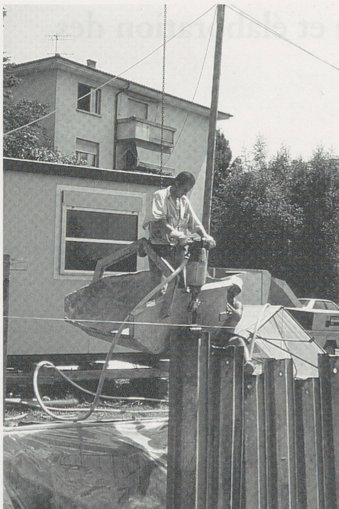
Fig. 7. Au cours du terrassement, les bords de la fouille menacent de s'effondrer. Comme c'est souvent le cas, la pose peu orthodoxe des palplanches nous prive d'une stratigraphie importante en travers du tertre funéraire du Musée romain... (photo P. Moinat, MHA VD).
