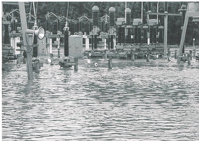
Umspannwerk bei Grimma unter Wasser.
