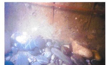
Bild 4. Bei einer Tauchinspektion können Unterkolkung wie auch Schäden am Bauteil festgestellt werden: freigelegte Armierung im Kolkloch einer nur siebenjährigen Brücke im Rhein.
