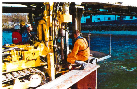
Bild 8. Vom Ponton aus werden in der Strömung Mikropfähle gebohrt (Brücke über die Reuss bei Gnadenthal).
