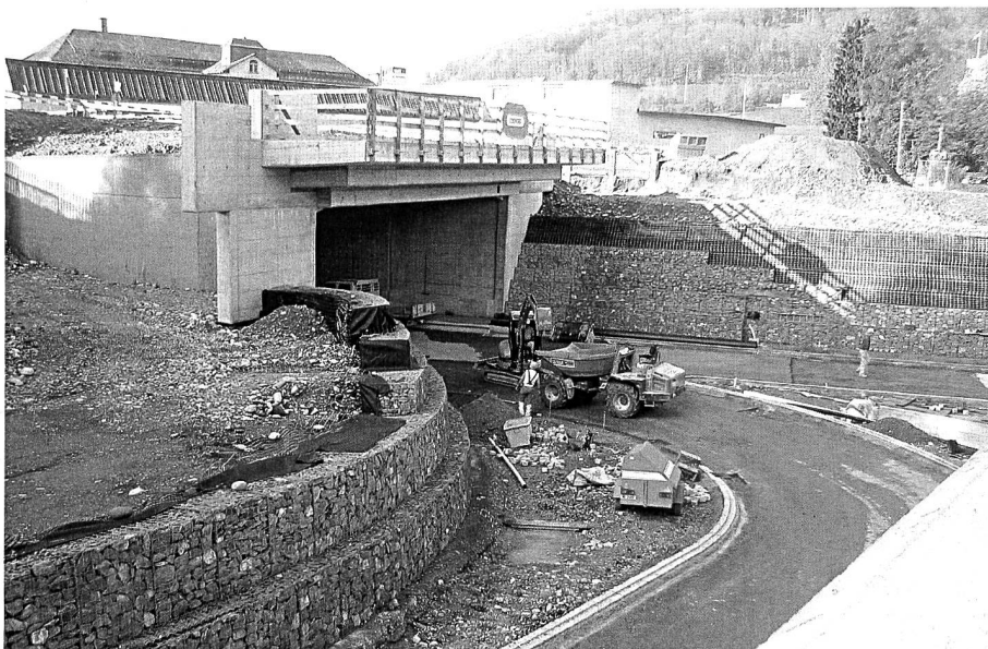
Ausfahrt aus dem Paradieslittunnel auf den Kreisel Bahnhofstrasse.
