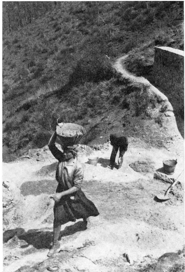
Eine junge Frau als Maurergehilfin beim Bau eines Hauses. Fotos Marion Rothenbach.
