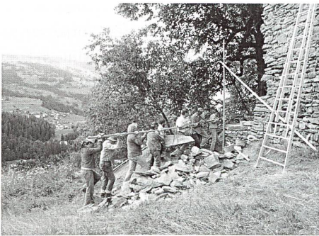
Abb. 53: Sils i. D., Burganlage Hohenrätien. Mauersicherung bei der West-Ecke der Burganlage. Mitarbeiter des ADG und Freiwillige transportieren einen Eckstein. Blick gegen Norden.
