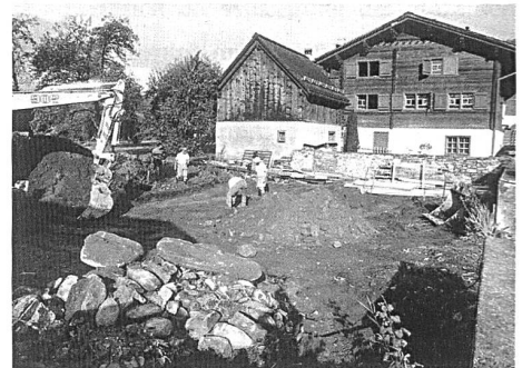
Abb. 44: Grüsch, Parzelle Nr. 159. Mit dem Bagger wird nach den Grundmauern des abgegangenen Gebäudes gesucht. Blick gegen Westen.
