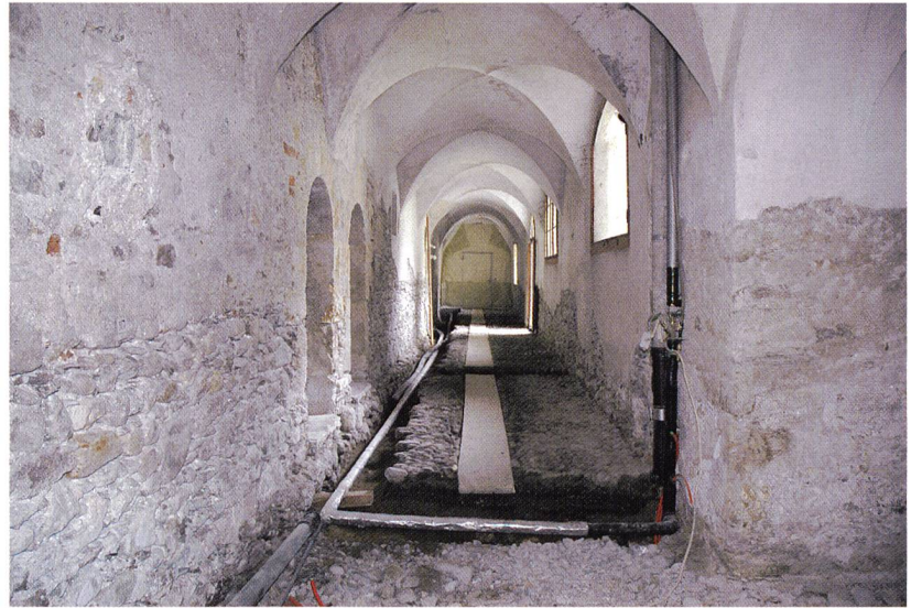
Abb. 32: Müstair, Kloster St. Johann. Nordtrakt, Erdgeschoss, Kreuzgang 11n. Übersicht über den Kreuzgang nach Entfernen der schadhafte Sockelputze und der Betonkanäle. Blick gegen Osten.
