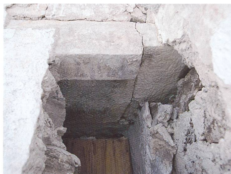
Abb. 61: Val Müstair, Müstair, Kloster St. Johann. Heiligkreuzkapelle, Westflanke der Nordapsis. Originale Obergeschosstüre mit Marmorsturz und ausgerissenen Laibungssteinen; Rückseite der Schranknische. Blick nach oben gegen Osten.
