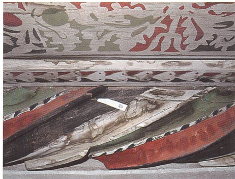
Abb. 110: Bergün/Bravuogn, evangelisch-reformierte Kirche. Holzleistendecke mit spiralförmigen Balken. Schadensbild vor der Restaurierung.
