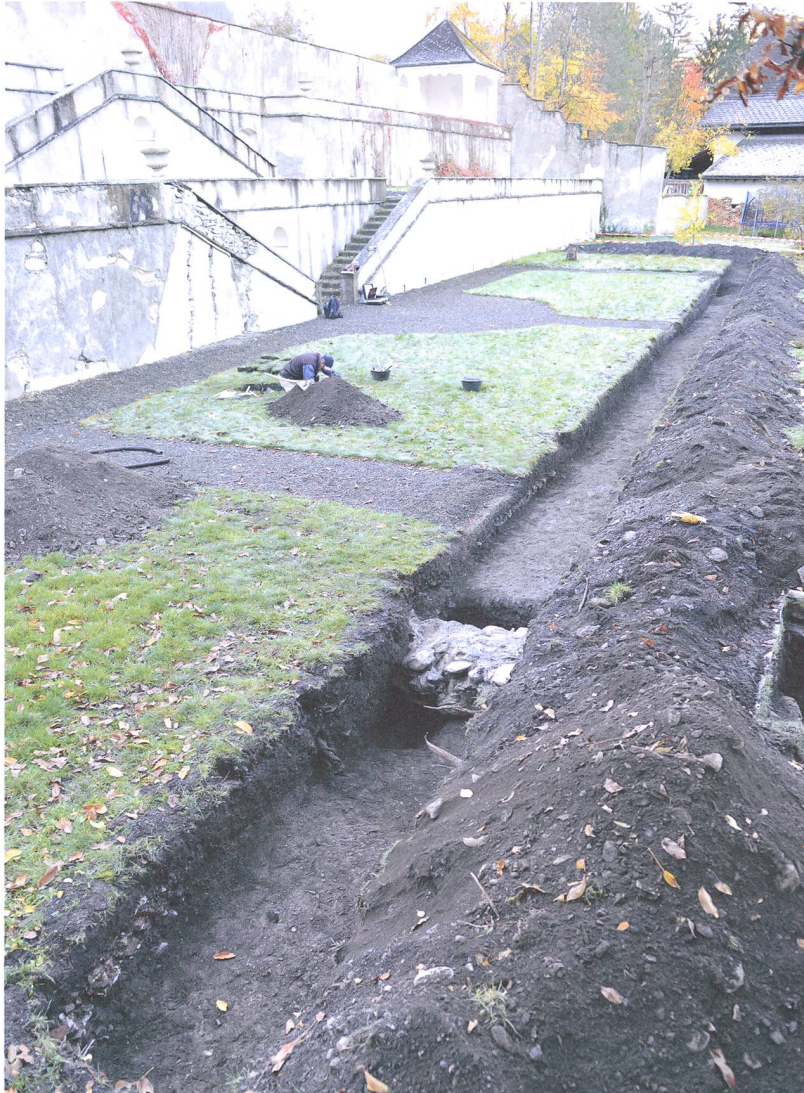
Abb. 4: Sils i. D., Palazzo Donatz, Garten. 2015. Die Sondierschnitte im südlichen Gartenbereich. Im Vordergrund ist ein Teil der Mauer unbekannter Funktion freigelegt (Schnitt 5). Blick gegen Westen.
