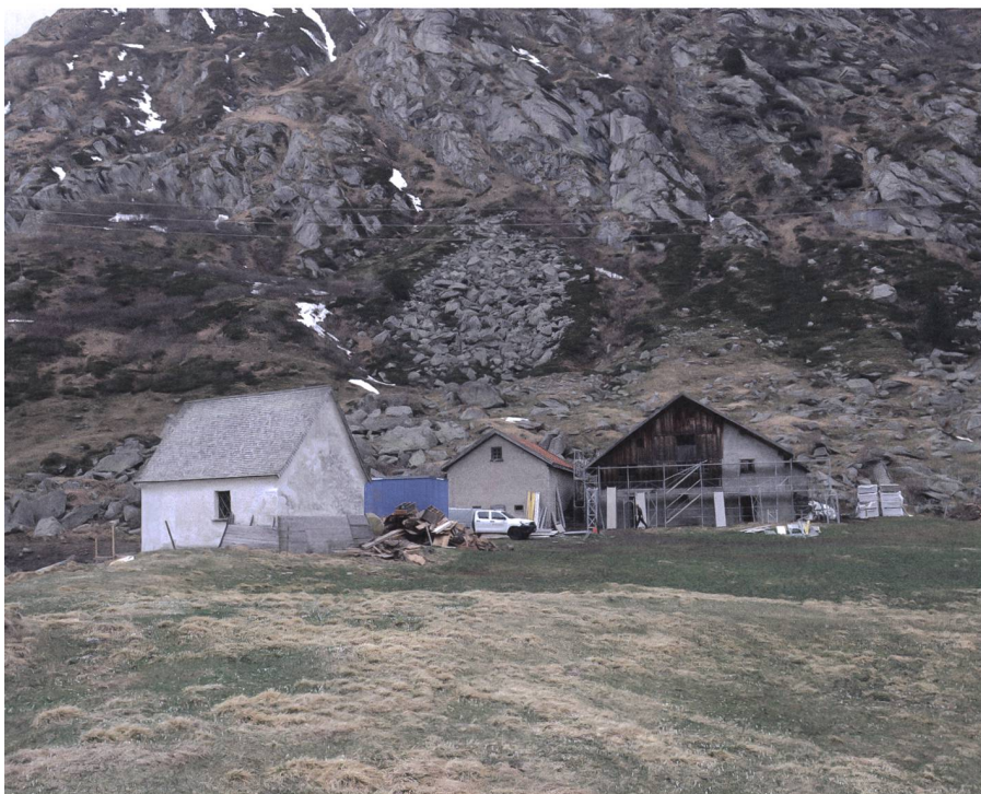
Abb. 1: Medel (Lucmagn), Alp Sogn Gagl. 2020. Das Alpgebäude/Hospiz mit Stall und Kapelle während den Umbauarbeiten. Blick gegen Westen.
