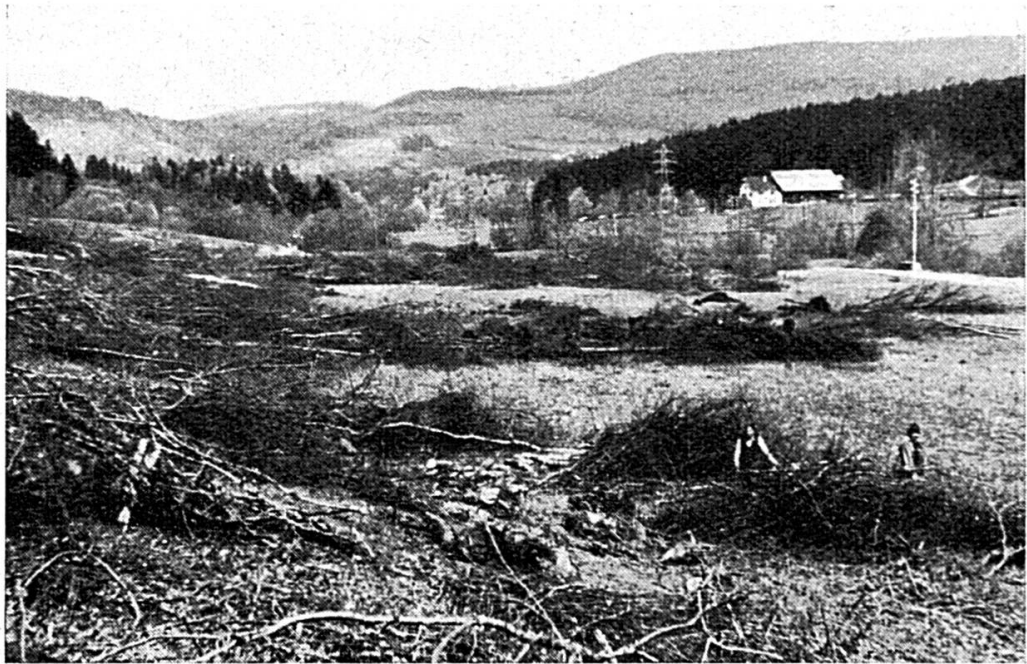
La surface du pré Borbet fut essartée, puis tout le sol fut encore drainé.
