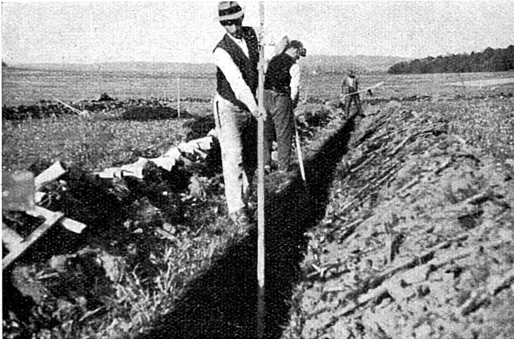
Travaux d'assèchement à Beurnevésin. — Le drainage. — Le maître draineur creuse, au fond du fossé, une gorge dans laquelle les drains seront couchés.
