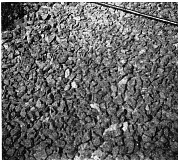
Couche de gravier dur 15/25 mm. compacté
