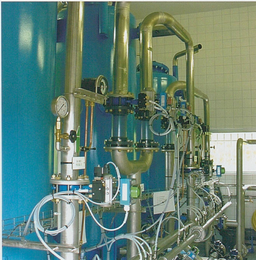
Filtres, comme on peut en trouver dans les petites stations de traitement d'eau potable de la région (Cornol, Vendlincourt, Alle, Vicques, etc.)
