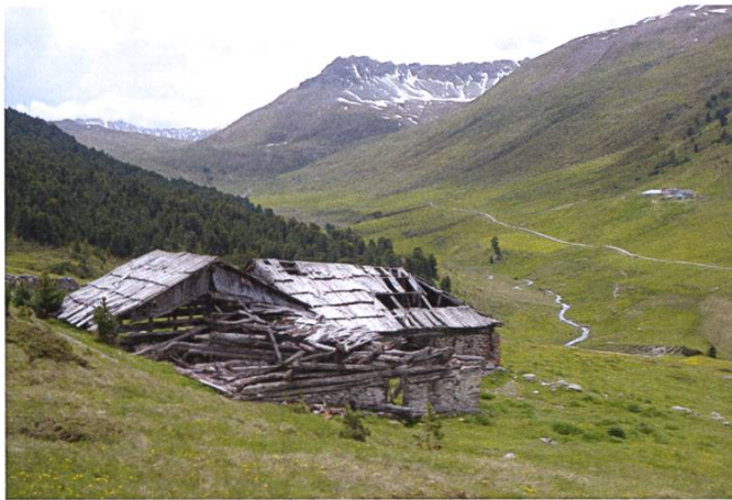
Abb. 6.1: Seit der Gründung der Genossenschaft Praditschöl-Astras-Tamangur zerfallen die Alpbäude der Alp Tamangur Dadora. Dreiräumige Sennhütte (1777d) mit Pferch und Schermen (1810d) (Foto: B. Furrer 2018)
