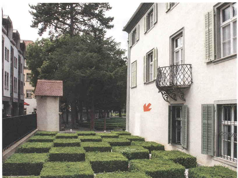
Abb. 2: Chur, Altes Gebäu, S-Fassade, Aufnahme 18.9.2012. Dunkle Flecken (Pfeil) beidseits des früheren Durchgangs zum Staubigen Hüetli .
