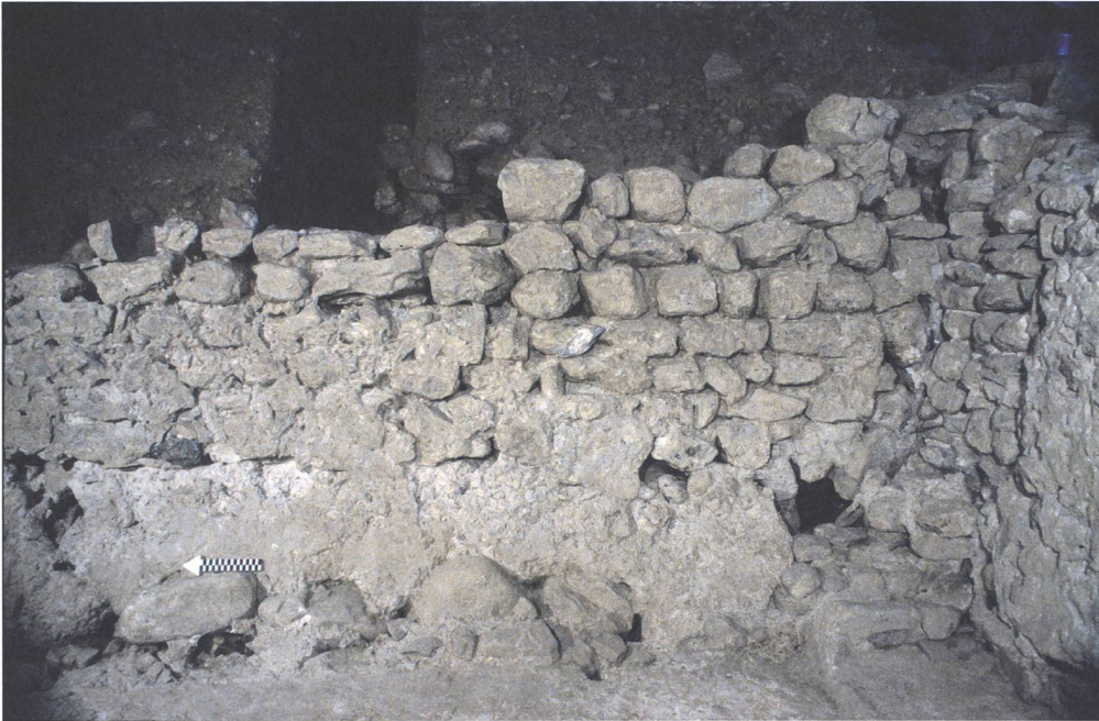
Abb. 139: Tomils, Sogn Murezi. Südannex E. Blick an die südliche Hälfte der Ostmauer (1029).
