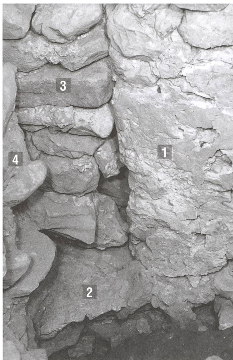
Abb. 247: Tomils, Sogn Murezi. Südannex E. 1 Östliches Türgewände des neuen Einganges (1031) mit Verputz (1071), 2 Reste der Türschwelle, 3 Zumauerung des Einganges, 4 Abbruchschutt (11). Blick nach Norden.
