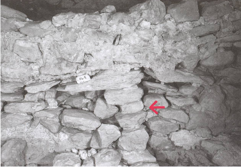
Abb. 229: Tomils, Sogn Murezi. Südannex E, Westerweiterung. Die Südmauer (333) der Westerweiterung stößt an die originäre Südwestecke des Annexbaus (Pfeil). Blick nach Süden.
