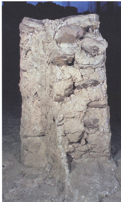
Abb. 328: Tomils, Sogn Murezi. Südannex E. Der Durchgang (1048) in der Binnenmauer (1047). Deutlich ist der Abdruck des Schwellenbrettes und des Türstocks im Mörtel zu erkennen. Blick nach Süden.
