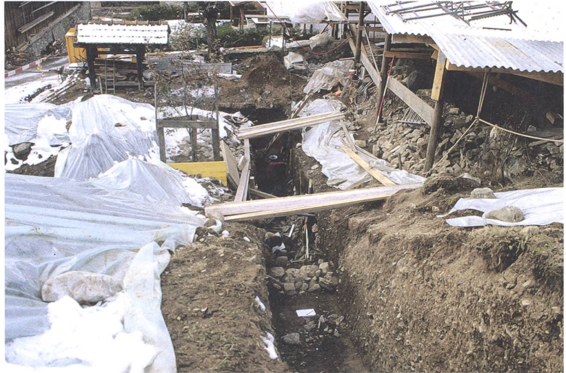
Abb. 418: Tomils, Sogn Murezi. Die Reste des an die Friedhofsmauer (50) angebaute Gebäudes aus dem 14. Jahrhundert kamen beim Aushub eines Leitungsgrabens zutage. Blick nach Westen.
