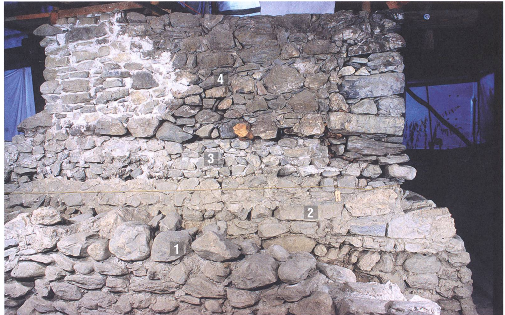
Abb. 450: Tomils, Sogn Murezi. 1 Reste der Südmauer des frühmittelalterlichen Südannexes E, 2 abgebrochene Friedhofsmauer (50), 3 erneuerter Mauerabschnitt (334), 4 neuzeitliche Trockenmauer (335), in Teilbereichen mit modernem Mörtel gesichert. Blick nach Süden.
