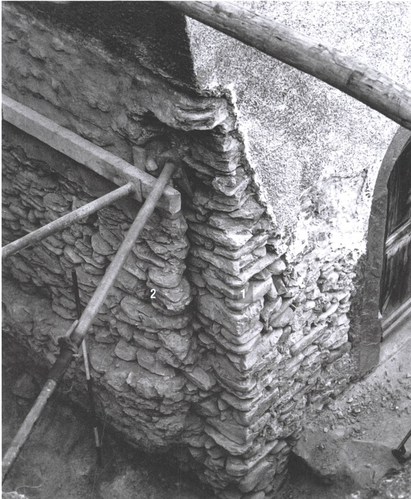
Abb. 27: Domat/Ems, Sogn Pieder. Beim Bau der karolingerzeitlichen Kirche wurde von Anlage 1 ein Teil der Westmauer übernommen. Erhalten blieb die Südwestecke 1. Die anschließende Partie der Westmauer musste wegen Feuchtigkeitsschäden immer wieder erneuert werden. Die vorspringende Mauer 2 samt Fundament ist im Spätmittelalter (Anlage 3) errichtet worden. Blick nach Nordosten.
