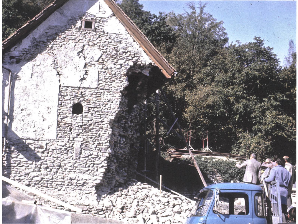
Abb. 136: Domat/Ems, Sogn Pieder. Anlage 2a. Kirche. 1976 kam es zum Einsturz der Nordostecke der Kirche. Blick nach Westen.
