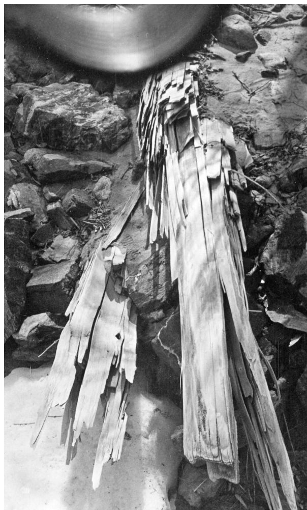
Abb. 65: Zernez. Susch (Stelle 8.7.2). Ausgefächerter Lärchenbalken des Holzkastens des westlichen Pfeilers der Punt Valmazun (B5).
