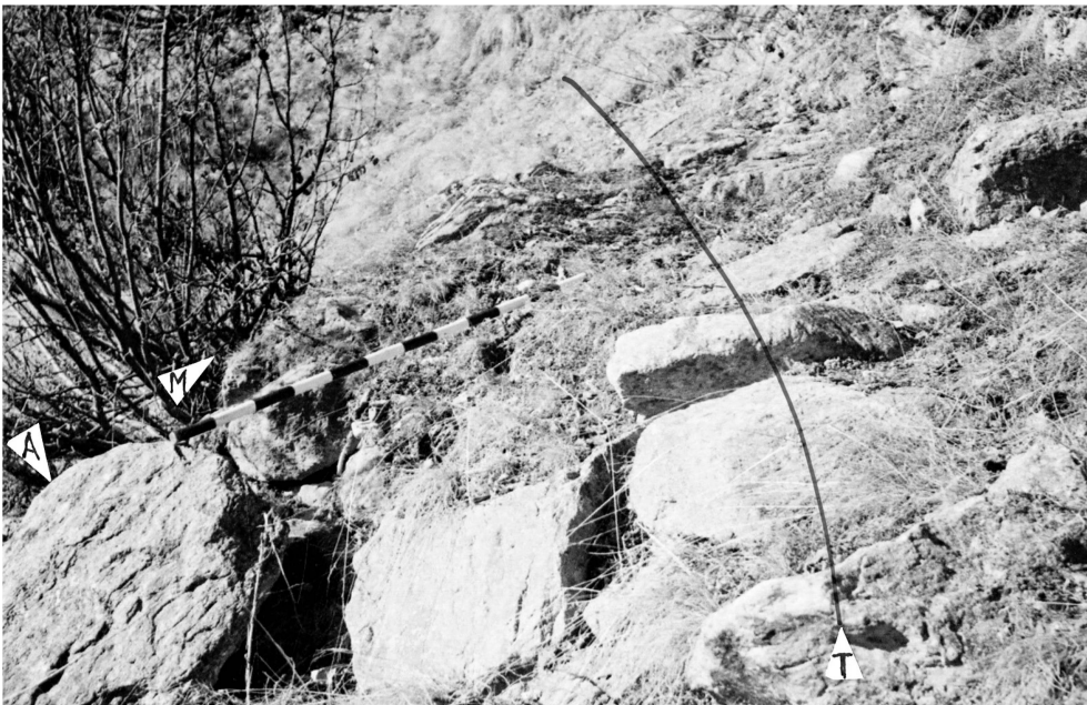
Abb. 87: S-chanf, Scalettapass (Stelle 11.1.3). Plaun Margun – Isla. Älterer Weg, linksseitig. Verfallener Stützmauerrest des älteren, linksseitigen Weges. A Abgerutschter Stein von M . M ursprüngliche Mauerflucht. T Wegtrassee. Blick nach Nordwesten.
