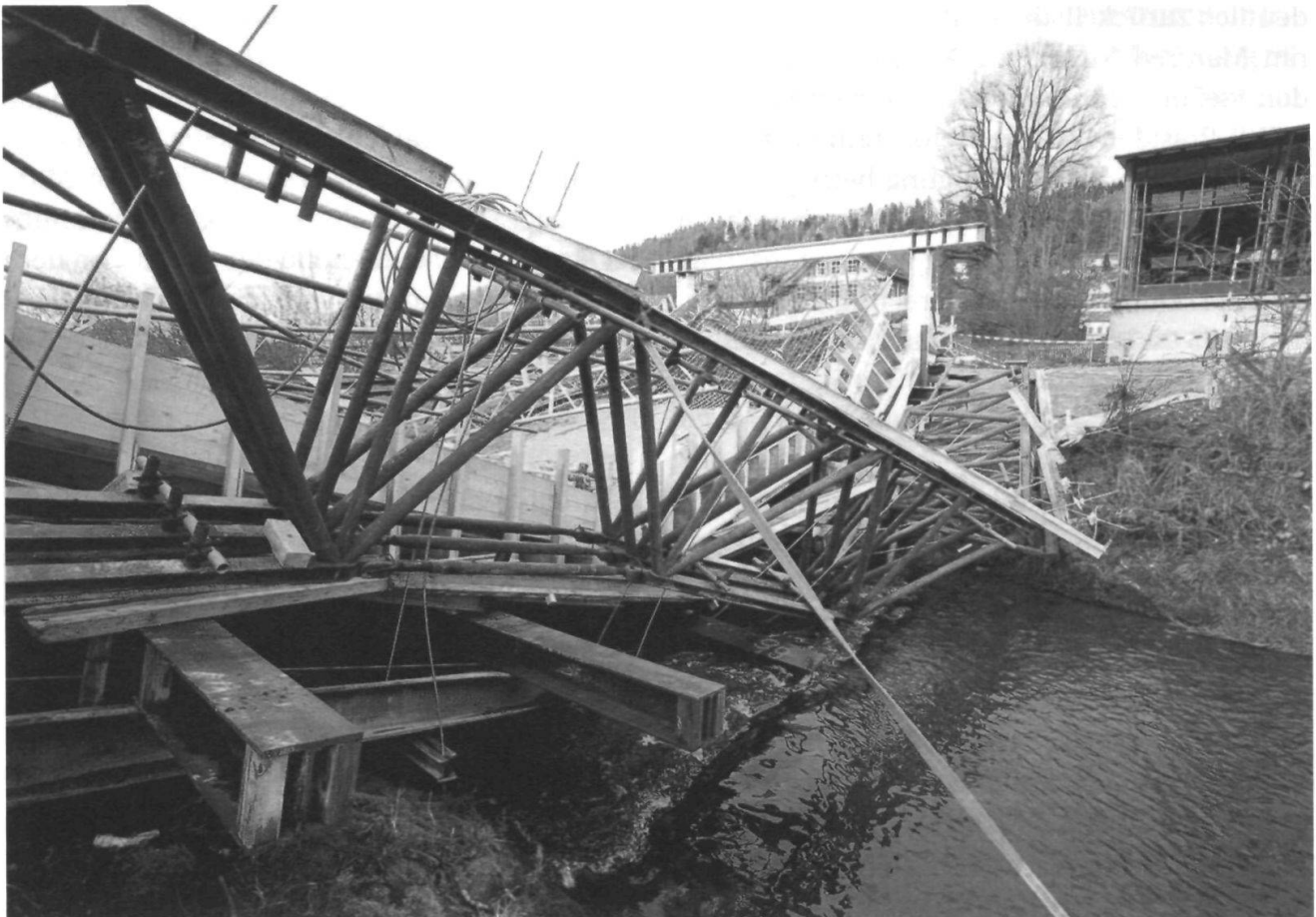
Halbwegs glimpflich verlief Anfang Dezember der Einsturz einer Brücke über den Rotbach. Sechs Bauarbeiter, die sich zur Zeit des Einsturzes auf der Brücke befanden, blieben unverletzt.
