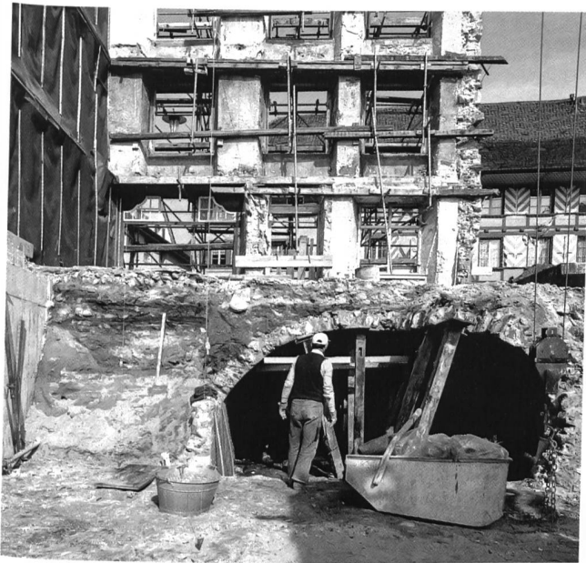
Abb. 135: Wiedlisbach, Städtli 9. Im Erdprofil links sind deutlich die von der Kellergrube durchschlagenen Schichten als schwarze Streifen erkennbar.
