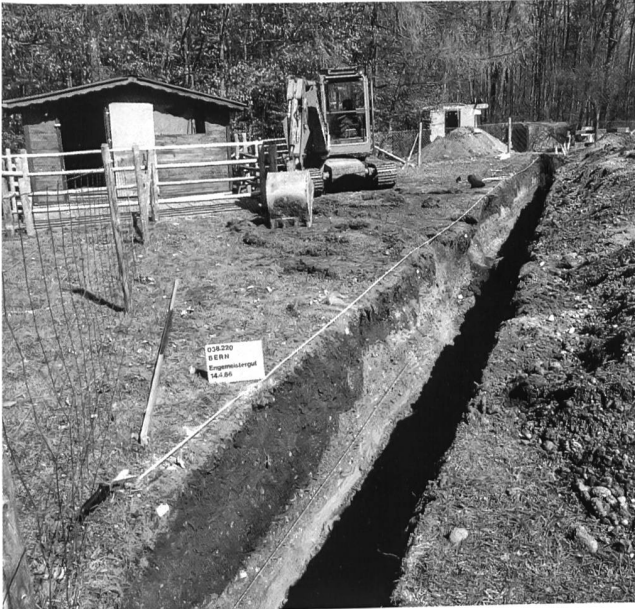
Abb. 3: Bern-Engemeistergut 1986. Westlicher Teil des BKW-Leitungsgrabens. Im Vordergrund flache Grube mit Holzkohle, aber ohne Funde.
