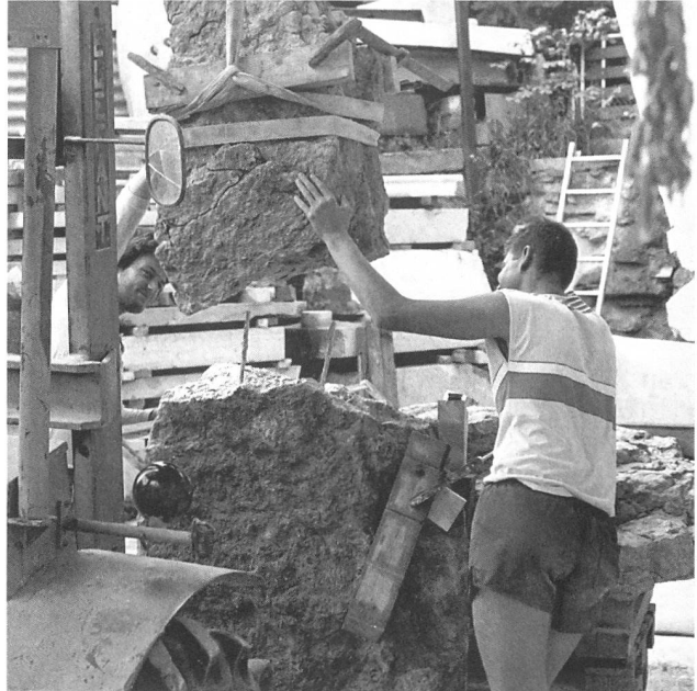
Abb. 16: Laufen - Dolmengrab. Restaurierung 1990/91. Ostplatte (10). Die zwei grossen Plattenteile werden durch zwei eingelassene Chromnickelstahl-Stäbe zusammengehalten.
