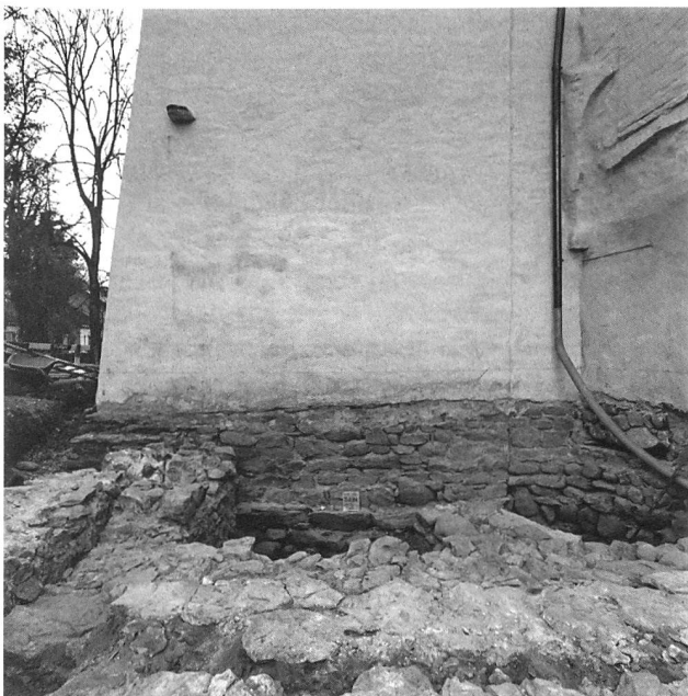
Abb. 24: Ostseite des Turmes mit Baunaht gegen die jüngere Chorschulter, den hochliegenden Kragstein. Oben rechts der Ansatz der ersten rundbogigen Blendarkade der Apsis.
