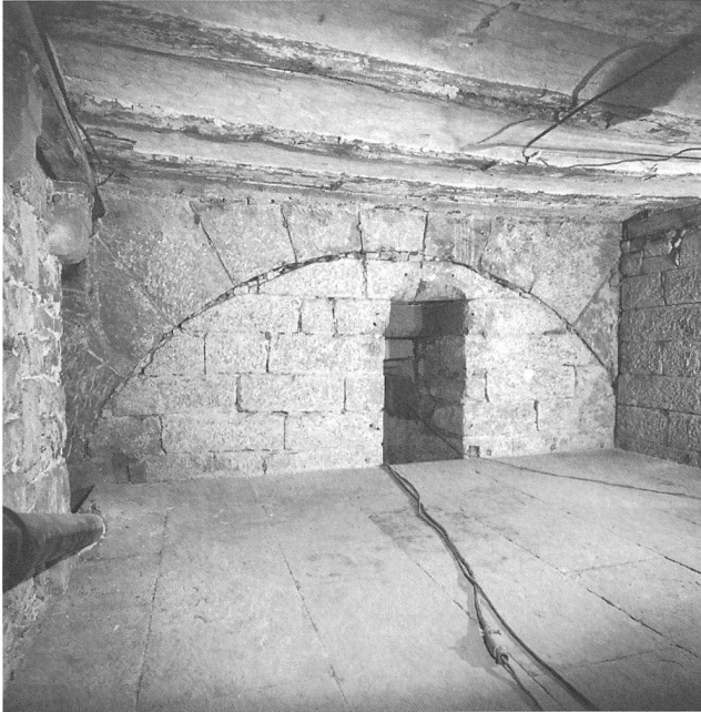
Abb. 15: Die Nordmauer des Lenbrunnens im Erdgeschoss mit dem gewaltigen Stichbogen (345) aus der Zeit um 1851.
