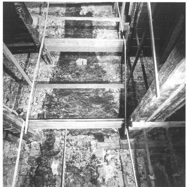
Abb. 12: Biel, Obergässli 5. Ostmauer (14) im 1. bis 3. Obergeschoss mit der Russchwärzung des Kamins, Blick nach Osten.
