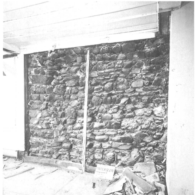
Abb. 11: Unterseen, Under de Hüsere 18. Erstes Wohngeschoss, Mauer (12) mit Eckverband. Blick nach Süden.
