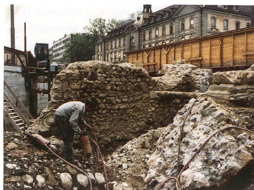
Abb. 9: Bern, Bahnhofplatz. Nur wenige Reste konnten dem Abbruchzahn widerstehen. Im Hintergrund die Fassade des Burgerspitals. Aufnahme Juli 1972.
