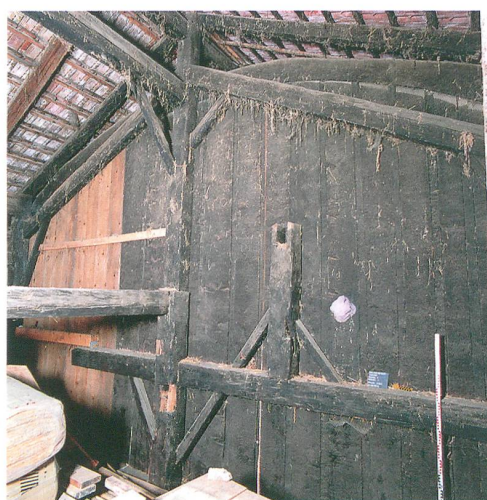
Fig. 2: Saules, Milieu du Village 9. Charpente avec les fermes superposées des 17 e et 18 e siècles. Vue vers l'est.
