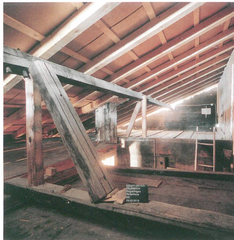
Abb. 17: Erlenbach, Ringoldingen, Heidenhaus. Dachraum. Übersichtsaufnahme in der östlichen Dachstuhlhälfte. Blick nach Südosten.
