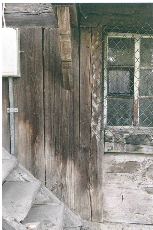
Abb. 24: Schwarzenburg, Junkerngasse 17. Übergang zwischen Küche und südöstlicher Stube. An den profilierten Eckständer der älteren Stube (links, mit Bundvorstoss und Bug) stösst der schmucklose Eckständer der jüngeren Küche (rechts). Blick nach Südwesten.
