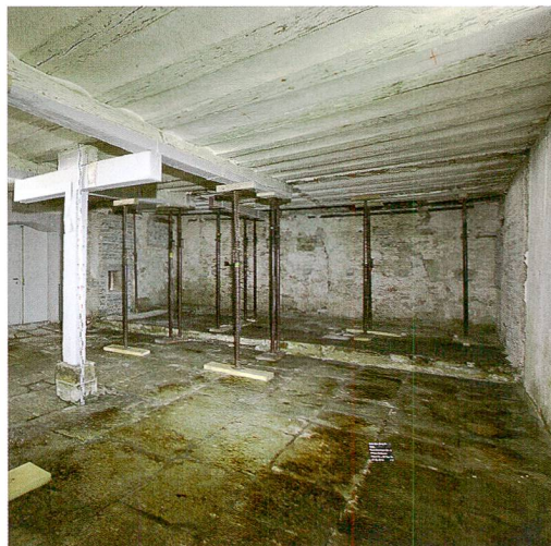
Fig. 2 : Bienne, rue Karl-Neuhaus 3. Le rez-de-chaussée se composait de deux pièces, dont le sol était couvert d'un magnifique dallage calcaire. Le solide solivage à entrevous maçonné du plafond est aussi d'origine. Vue vers le nord.
