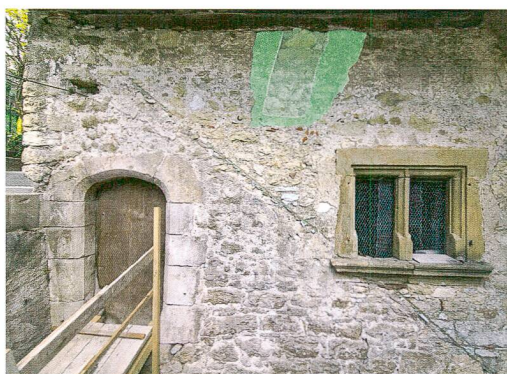
Abb. 4: Twann-Tüscherz, Dorfgasse 9c. Westfassade mit Bogenportal zum spätmittelalterlichen Primärbau. Kamin- und Fenstereinbau (grün) stammen aus dem späten 17. Jahrhundert.
