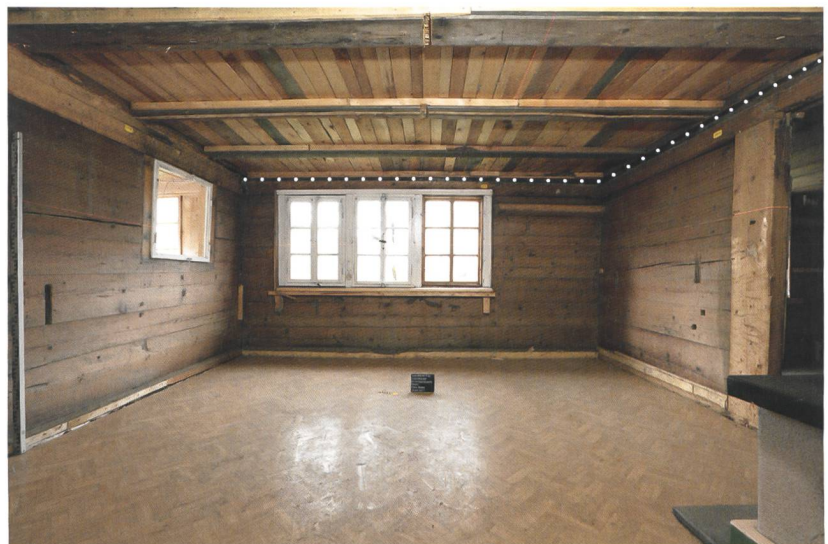
Abb. 3: Adelboden, Hirzbodenportstrasse 10. Blick in die Wohnstube. Die Wände waren bis zur modernen Vertäfelung immer auf Sicht. Die ursprüngliche Deckenhöhe ist am genuteten Deckenrähmbalken noch ablesbar (weisse Punkte). Blick nach Südwesten.
