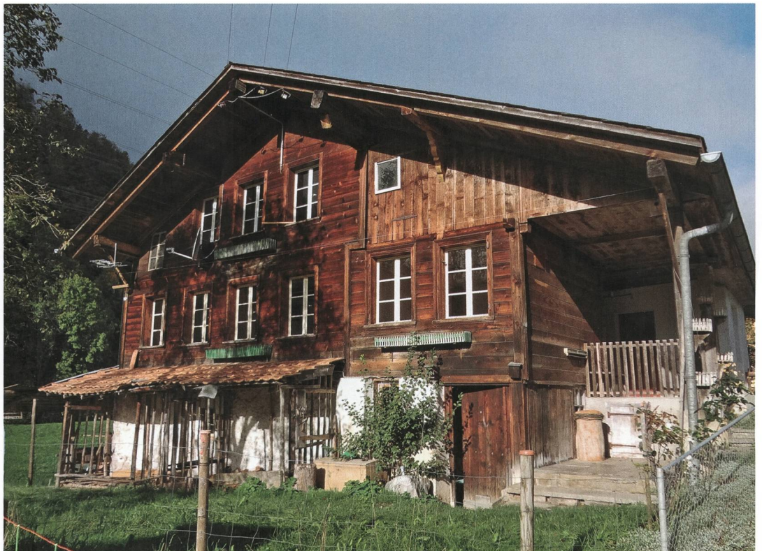
Abb. 1: Stocken-Höfen, Stockentalstrasse 33. Ostfassade des Gebäudes vor den ersten Untersuchungen im September 2012. Blick nach Westen.
