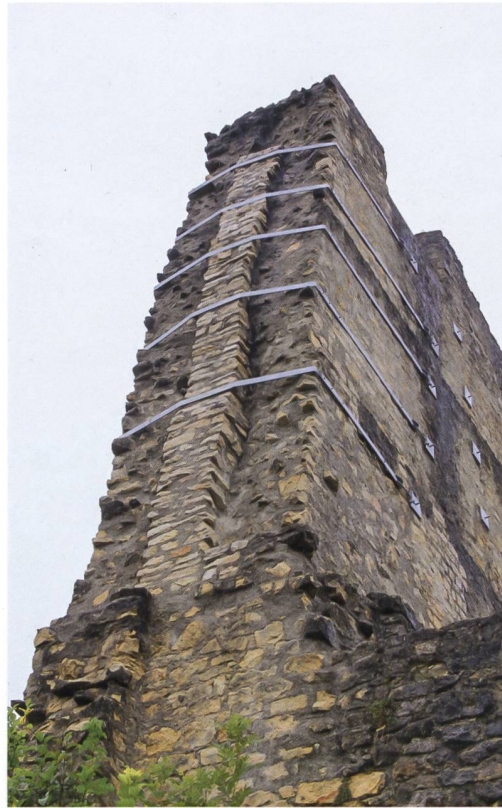
17 Ormalingen BL, Farnsburg. Das Mauerwerk wird mit einer Vormauerung und Stahlbänder gesichert. Blick nach Nordwesten. Aufnahme von 2020.
