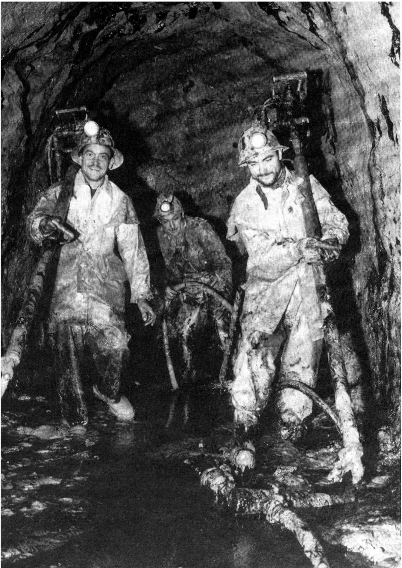
Beim Bau des Gönhardstollens, durch welchen das Abwasser aus dem Raume Entfelden zur im Bau befindlichen regionalen Kläranlage fliessen wird, stiessen die Stollenarbeiter auf Molasseöl.
