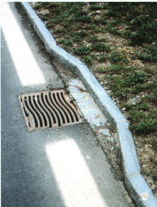
Abb. 14: Amphibien-gerecht gebauter Einlaufschacht.
