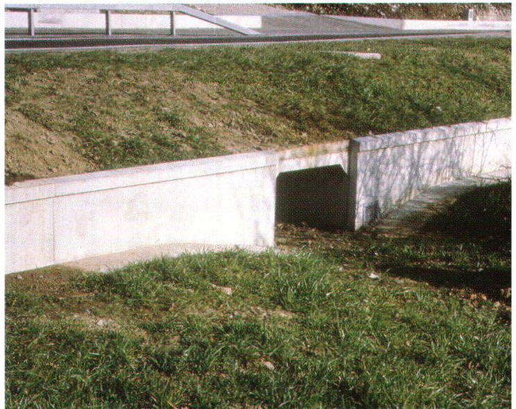
Abb. 17: Ein Betondurchlass ermöglicht nicht nur Amphibien, sondern auch anderen Kleintieren ein gefahrloses Überqueren von Strassen.
