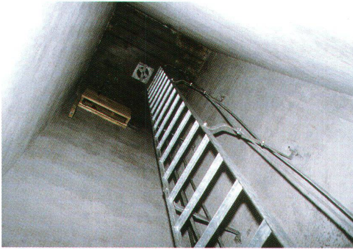
Abb. 8: Montierter und geöffneter Kasten im Innern eines Brückenpfeilers.
