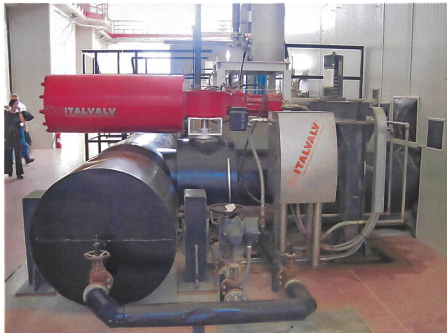
Abb. 24: Druckregulierung im geothermischen Kraftwerk Sasso II in Larderello – 16 MWe / Foto: M. Eberhard
