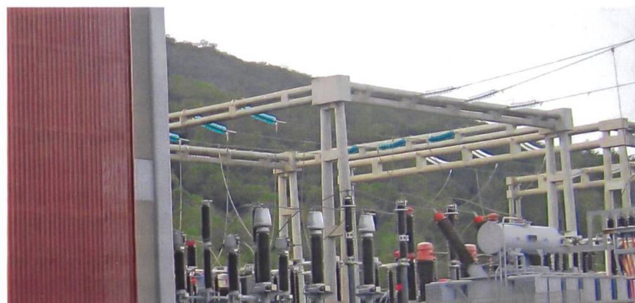
Abb. 26: Transformator und Stromverteilung im geothermischen Kraftwerk Sasso II in Larderello / Foto: M. Eberhard
