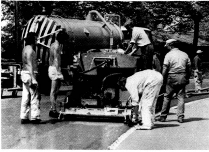
Einbauen des Kunststoffbelages (Grundschrift) Mise en place du revêtement synthétique (couche de fond) Placing the plastic coat (primary layer)
