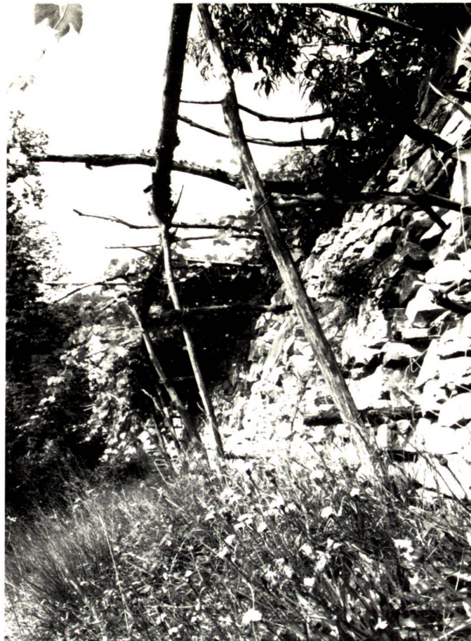
En haute à gauche: Première mesure importante pour l'aménagement d'un jardin habitable sur le coteau, la construction d'un mur de soutènement approprié du point de vue du matériel et des conditions locales.
