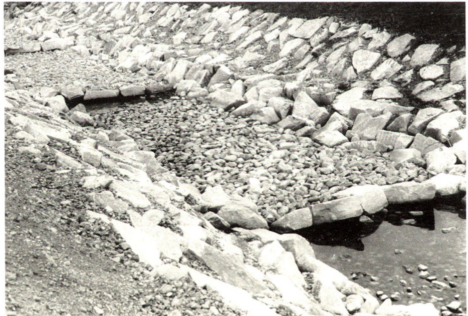
Neue Lorze 1973. Nach dem Bau, ohne Wasserführung und Bepflanzung. Foto: ARP/P. P. Hegglin
